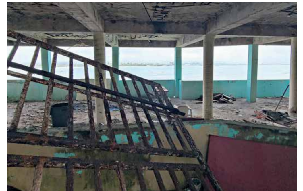
Figura 1.6 Estado actual de la antigua casa del club de pesca recreativa de Isla de Cabras. Fotografía autor (2022)
