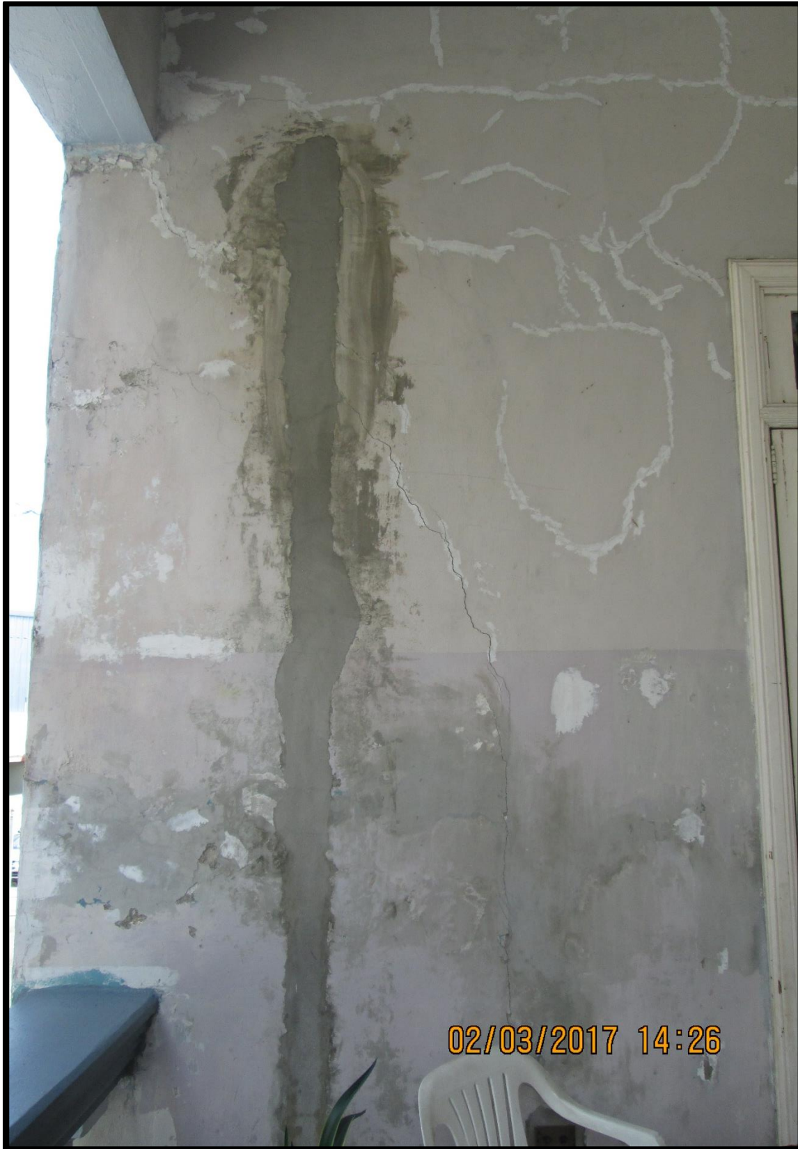
Imagen 30: En esta fotografía se puede ver claramente que las reparaciones a las fisuras, las coberturas de los ductos eléctricos con cemento fueron realizadas como cualquier trabajo de reparación y ningún criterio de conservación. Fuente: Archivo Fredy Caballero.
