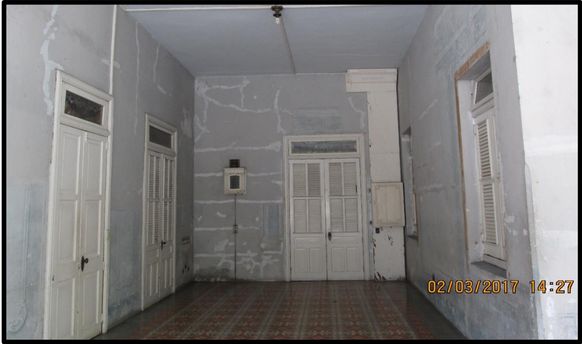
Imagen 26: Patio externo de la casa. Se puede observar las marcas de color blanco dejadas para cubrir las grietas de las paredes y las canaletas de plástico. No se tuvo ningún criterio de preservación. Fuente: Archivo Fredy Caballero.
