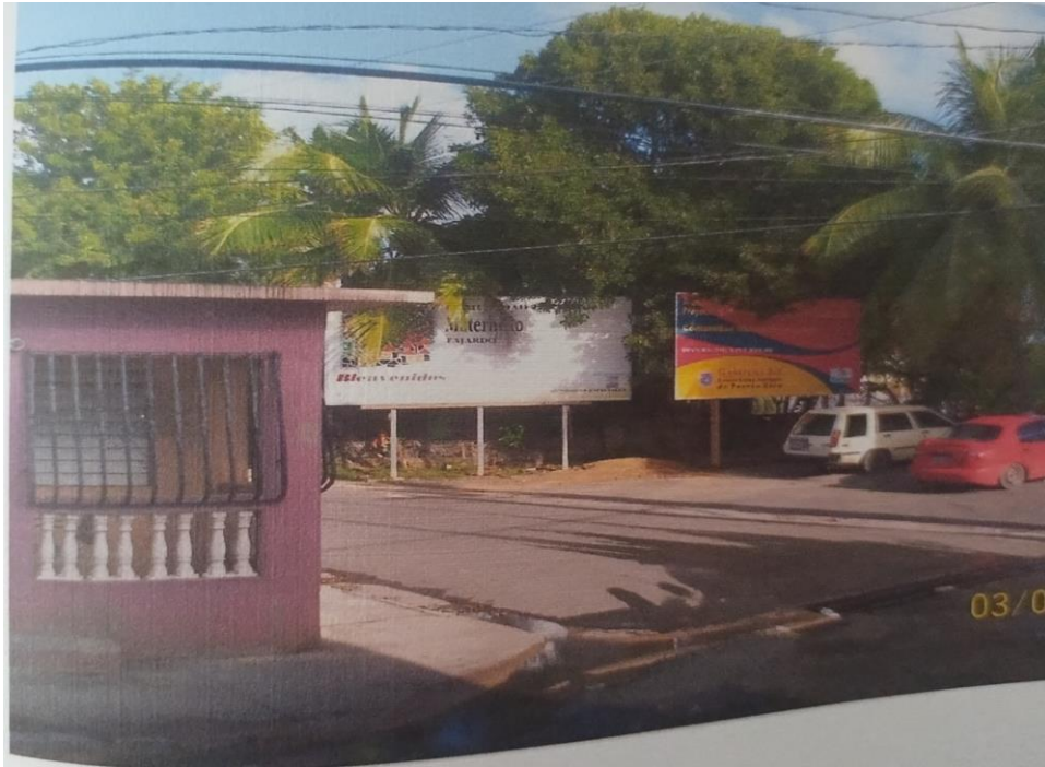
Figura 6. Foto de problemas relacionados con el desagüe de una alcantarilla en pésimas condiciones entre las comunidades de Mansión del Sapo y Maternillo. (2002).
