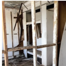
Condición de paredes divisorias interior del apartamento 2 6
