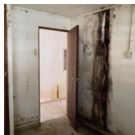
Mancha de humedad en paredes del apartamento 3 9
