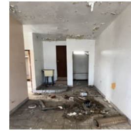
Condición interior del apartamento 4, baño elevado del nivel de losa 2
