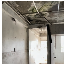
Mancha de humedad en el techo del apartamento 2 7
