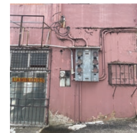
Contadores eléctrico en la fachada lateral
